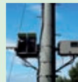
▲ 送電線用故障区間検出装置 (ニシム電子工業(株)製)
