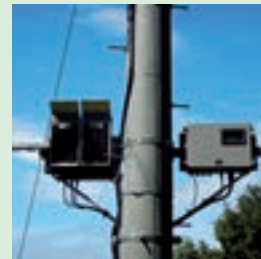
▲ 送電線用故障区間検出装置 (ニシム電子工業(株)製)
