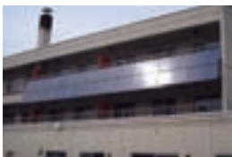
■帯広支社に設置された「集合住宅向ベランダ設置型の太陽光発電装置」 設備概要：3KW相当モジュール(185W × 18枚)、パワーコンディショナー、パワーモニター
